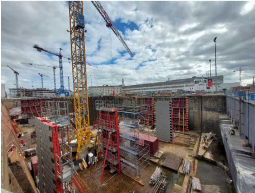
Vue du chantier des ouvrages de renforcement du fort Boyard, dans le port de Nantes - Saint-Nazaire, lors d'une visite en avril 2026. © J.I. pour Batiactu
